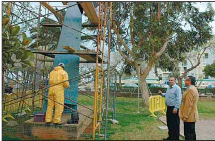
El Alcalde, Rafael Albert, y el Jefe de la Brigada de Obras, Francisco Aparici, supervisan la limpieza de una de las esculturas.
